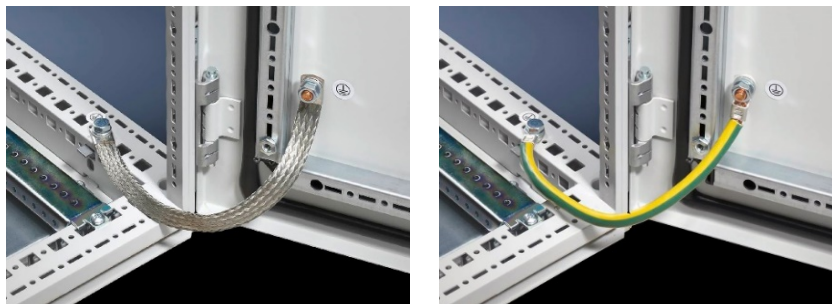
شکل ۶-۹- استفاده از سیم با روکش زرد-سبز یا تسمه مسی با روکش قلع برای هم‌بندی قطعات فلزی متحرک تابلو برق
